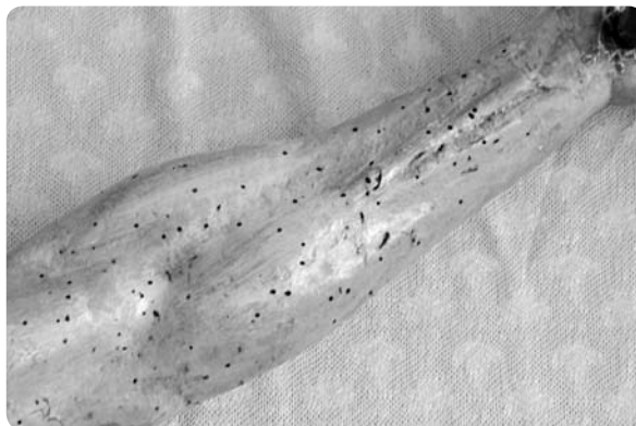
Zniszczenia spowodowane przez drewnojady
